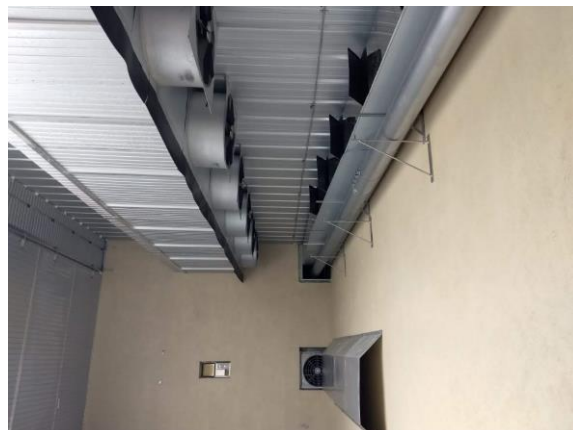
Foto 42: ventiladores e dutos de ar
