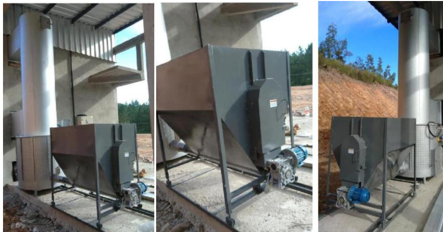
Fotos 30, 31 e 32: proteções do alimentador e fornalha
