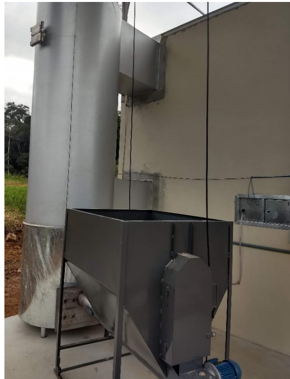
Foto 3: alimentador, fornalha e trocador de calor
