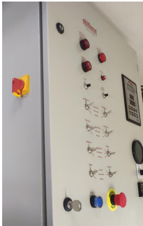
Foto 4: chave geral quadro elétrico
