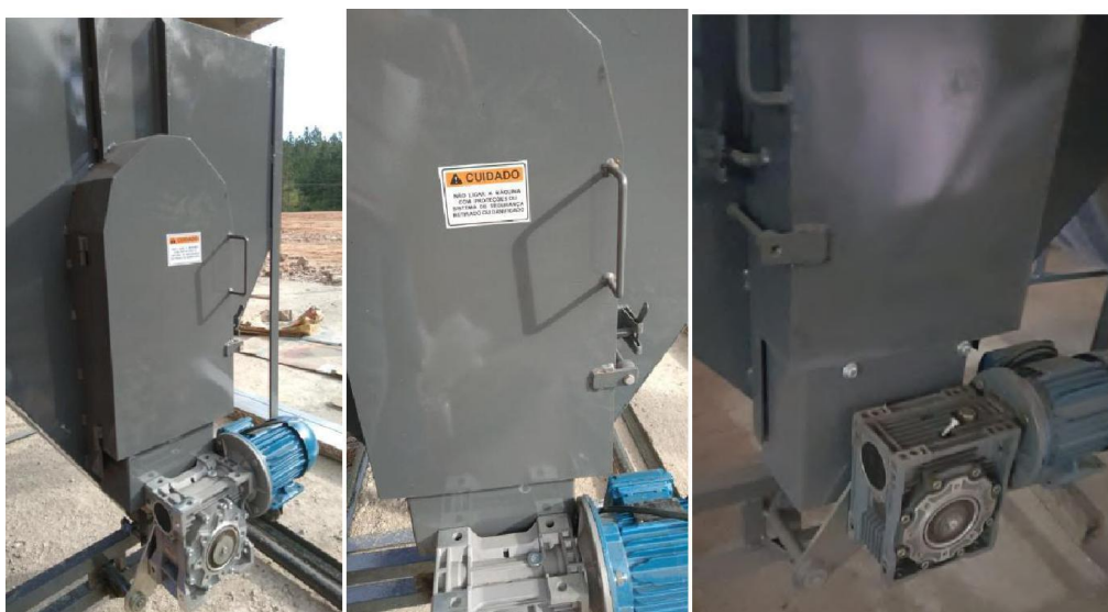
Fotos 33, 34 e 35: Proteção transmissão do alimentador
