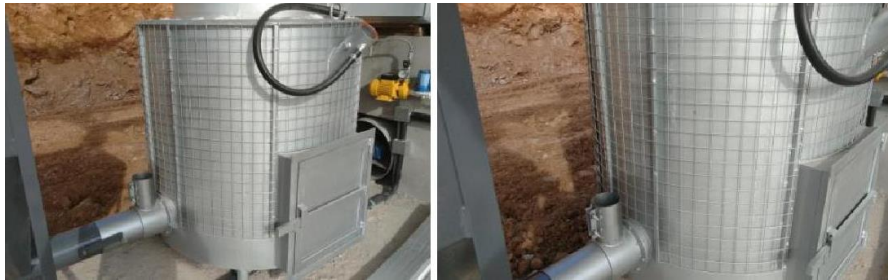
Fotos 28 e 29: grade de afastamento da fornalha, devido a superfície aquecida
