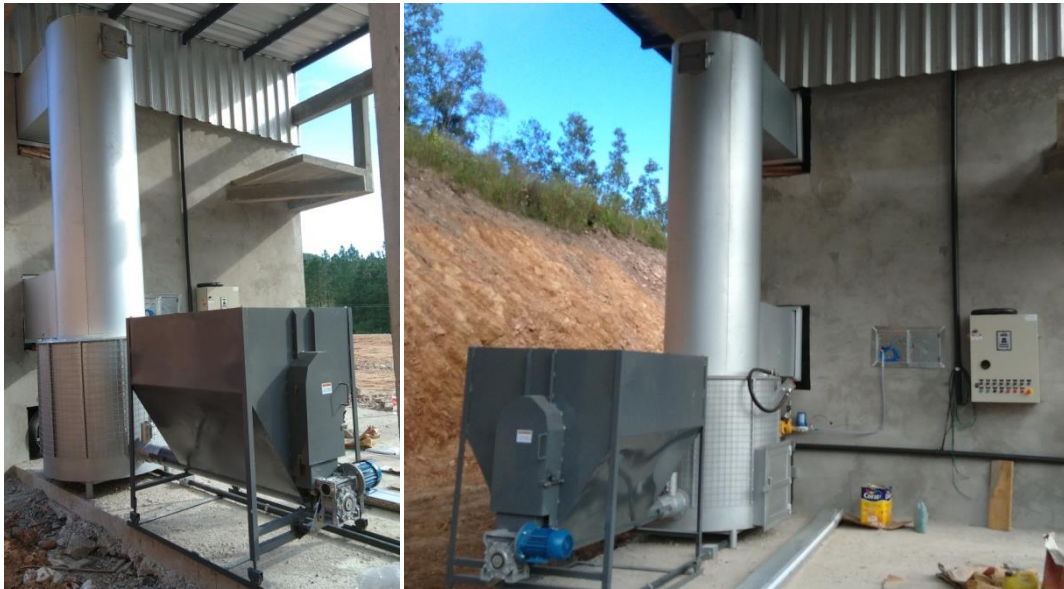
Fotos 18 e 19: Alimentador, trocador de calor e quadro elétrico
