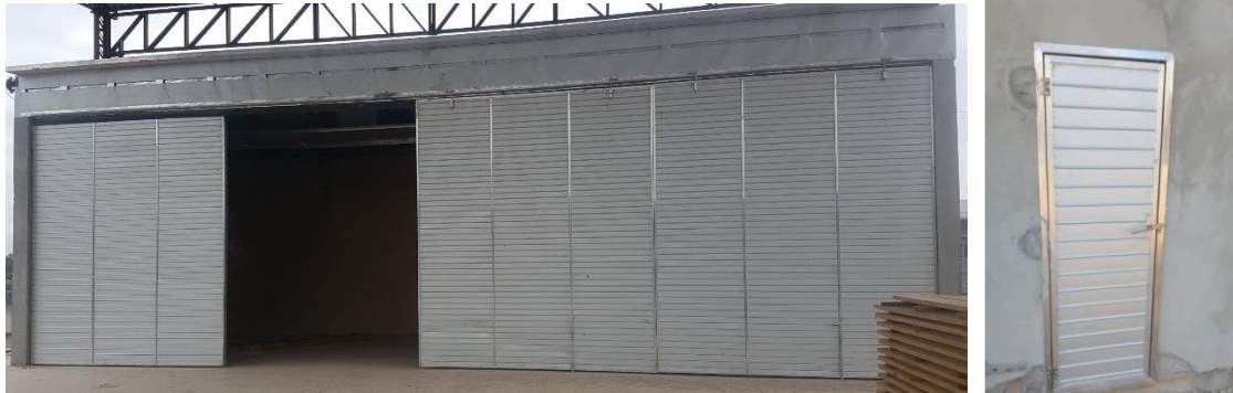
Fotos 38 e 39: porta principal para carregamento e porta de inspeção lateral
