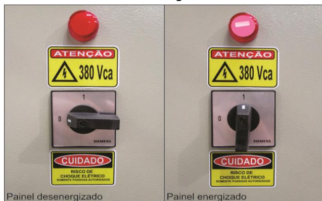
Figura 136 - Figura 124. Alimentação do painel de comando. Posição 0: Painel desenergizado. Posição 1: Painel energizado.
